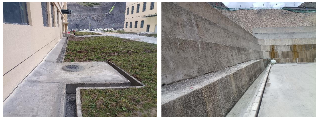
办公生活区矩形混凝土排水沟
